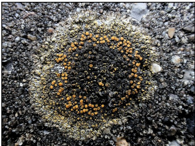
Betonicitroenkorst (lichtgrijze lobben rondom)
