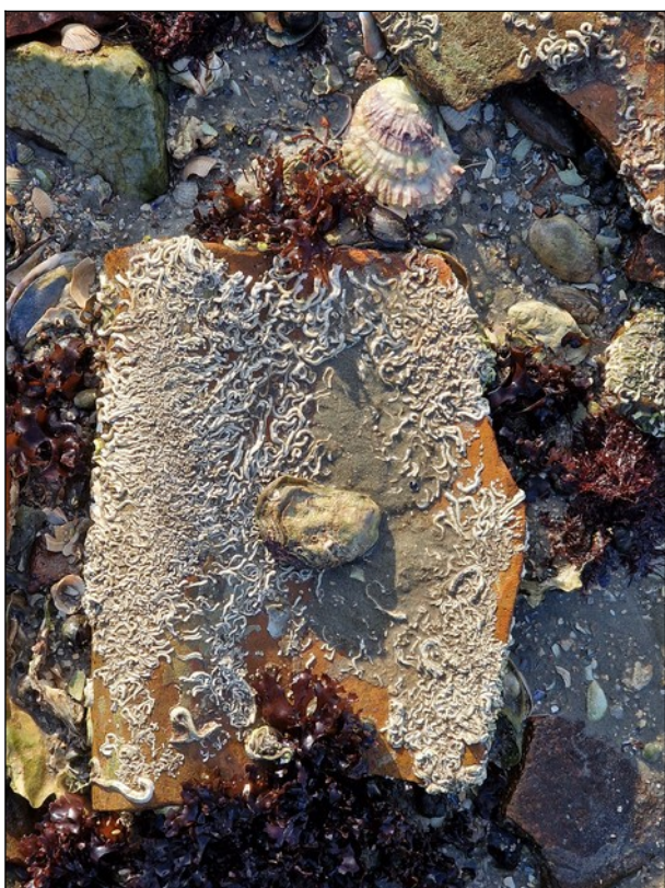
Bovenzijde dakpan met Driekantige kalkkokerworm
